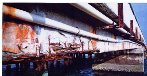
劣化した構造物
