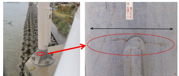
写真 1 照明柱の疲労損傷例
