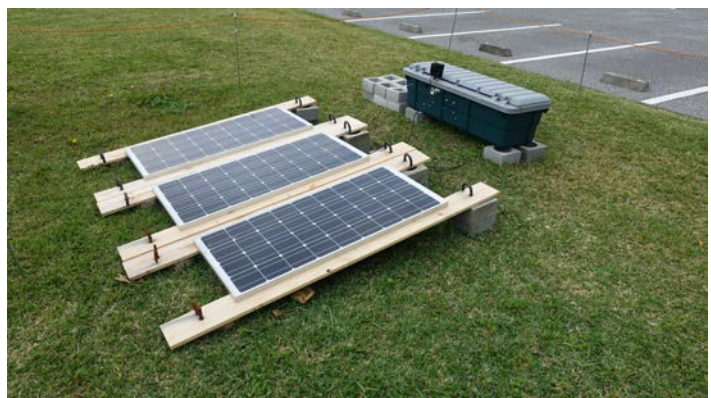
図1 太陽電池（工学部駐車場）
