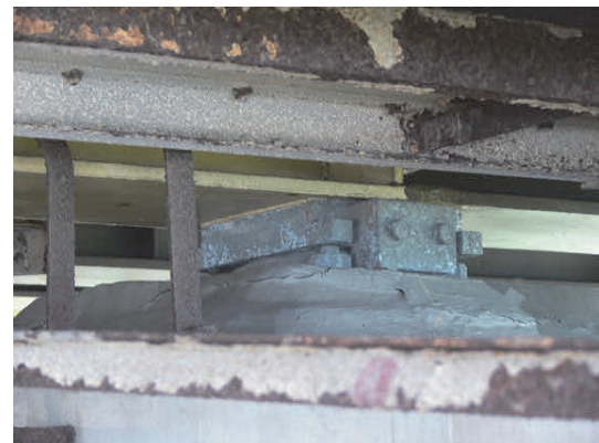
腐食事例：橋梁の桁内部の腐食
