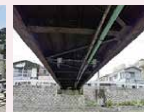
▲橋梁の腐食モニタリング
