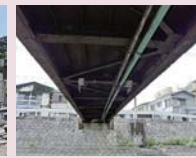
▲橋梁の腐食モニタリング
